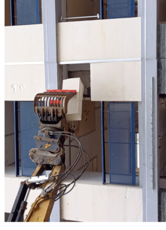
Tests de dépose avant le marché puis après le démarrage des travaux. NPNRU Sanitas, Tours Habitat.
